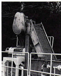
東京都日野市多摩平下水処理場
