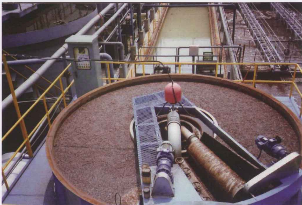
DAF 加壓浮除設備
