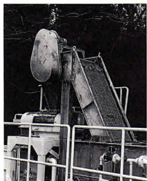
東京都日野市多摩平下水処理場
