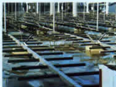
下水処理場 エラストックスロール
