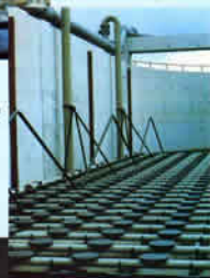
下水処理場 エラストックステラー
