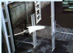
散気管昇降装置と垂直軸攪拌機
