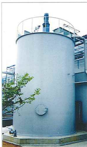
工場排水 (75m³槽)
