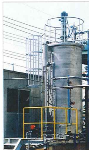
工場排水 (5m³槽)
