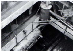
泥土・泥水シールドハッチタンク吸引・回収システム (スーパーバキューム22kW, 排水ポンプ5.5kW)
