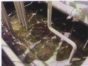
最終處理場 浸出水處理設施
