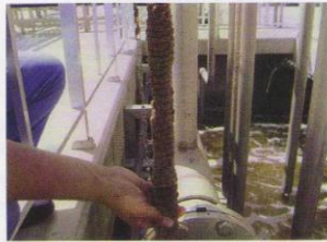
浸出水處理設施 氧化槽污泥附著狀況
