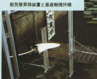
散気管昇降装置と垂直軸攪拌機
