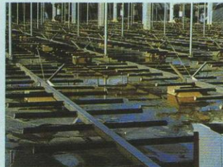
下水処理場 エラストックスロール
