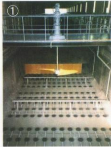
①無酸素槽・硝化槽 分離型 (下水処理センター)
