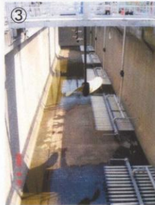
③硝化槽・脱窒槽 兼用型 (民間ビール工場)
