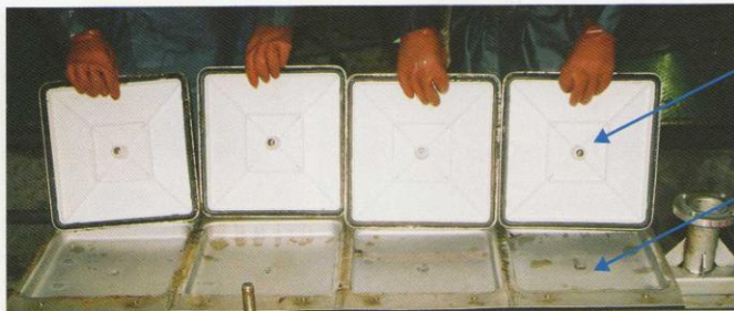
M市A浄化センター
