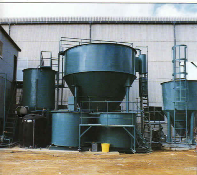
汚水処理シグーナ。毎時100t/Hとセットされた水処理全景。
