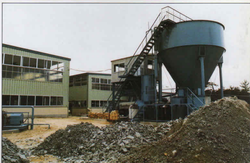
水処理装置とセットされた濾過室全景
