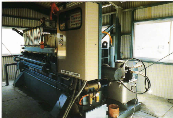
濾過室で無人運転中の汚泥脱水機SE-750-22P型ポンプ式
