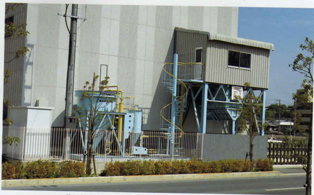
生コンクリート汚泥脱水装置 ▲
