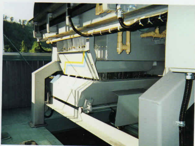
▲運転中のSE-750全自動脱水装置
