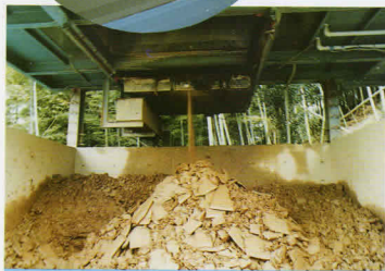
▲ 汚泥ケーキ貯留基地
