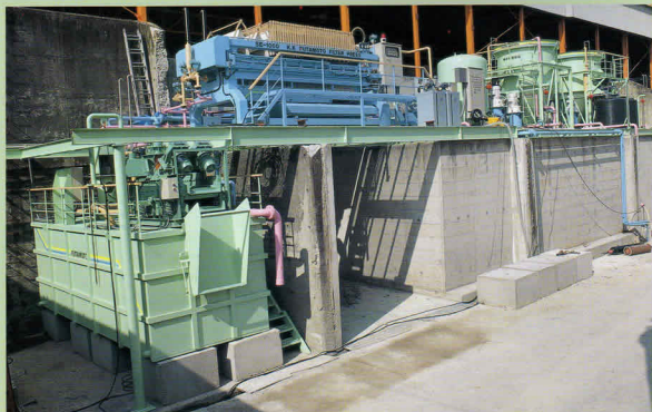
現地据付型に据付されたSE1000型同機種、水処理装置とセットされたプラント水処理量毎時50T/HフィルタープレスSE1000型 ケーキ容量1100ℓ 砂取りフラインジ機とセットされたベントナイト他廃棄物処理、中間処理兼用プラント工場全景
