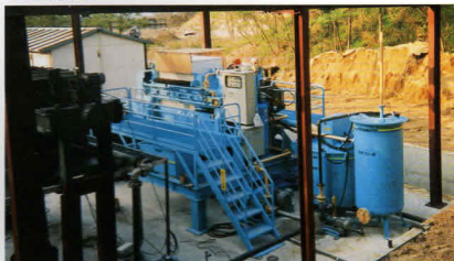
油濾過脱水全景
