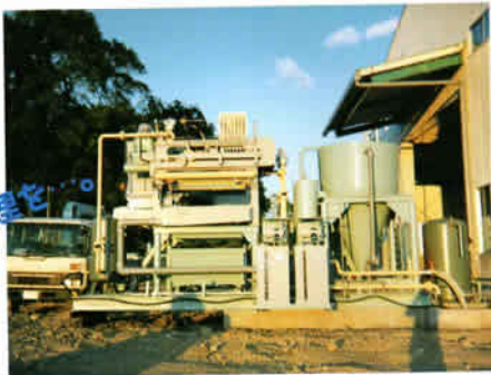
シクナー廃水処理装置
