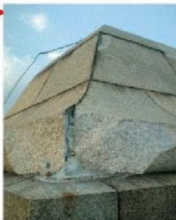
議事堂のまさに最頂部に生じた破損。2段目の小さい破損も今回修復された。
